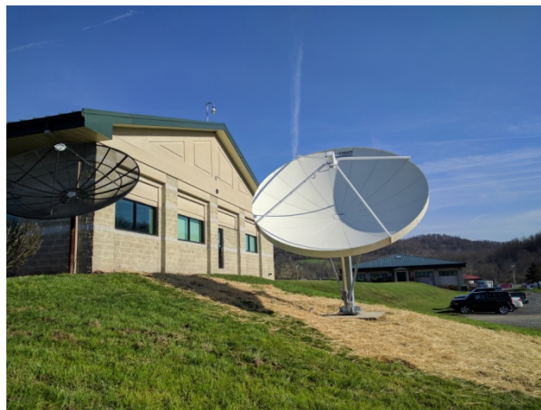
Antena de 4.5 metros para Sistema Terreno GRB
